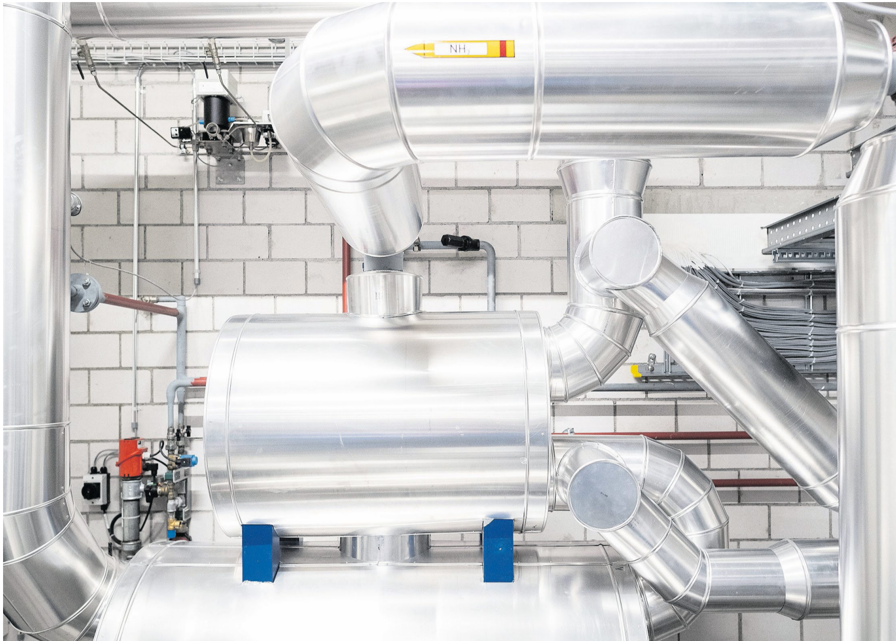
In der Kläranlage Rötli in Neuhausen am Rheinfall hebt eine Wärmepumpe die Temperatur des Abwassers auf ein nutzbares Niveau an.
